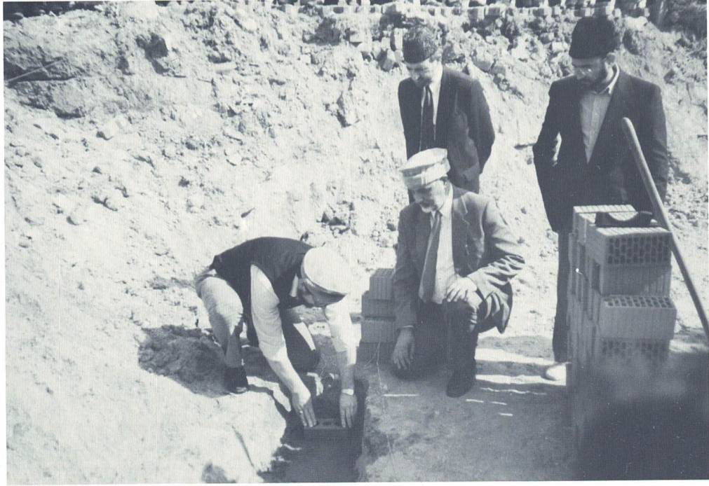
۱۳ اپریل ۱۹۹۱ء کو مکرم عبداللہ و اگس ہاؤز رامیر جماعت اصدیہ جرمنی ناصر باغ میں نئی تعمیر ہونے والی عمارت کا سنگ بنیاد رکھ رہے ہیں
